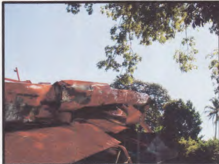
FOTOGRAFIA No. 7 DAÑOS EN LOS PLANOS
